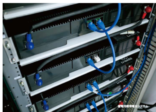
図3 蓄電池棟の大型蓄電システム
